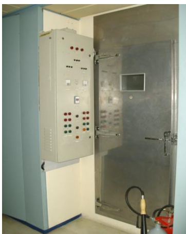
Εικόνα 3. Εργαστήριο Φυσικοχημείας: Ψυκτικός θάλαμος
