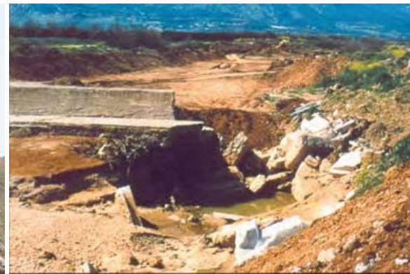
Αποκοπή γέφυρας μετά από μεγάλη πλημμύρα του Ίναχου ποταμού (Αργολικό πεδίο)
