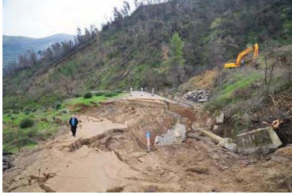
Κατολίσθηση στο οδικό δίκτυο Κρεστένων – Ανδρίτσαινας μετά τις πυρκαγιές του 2007
